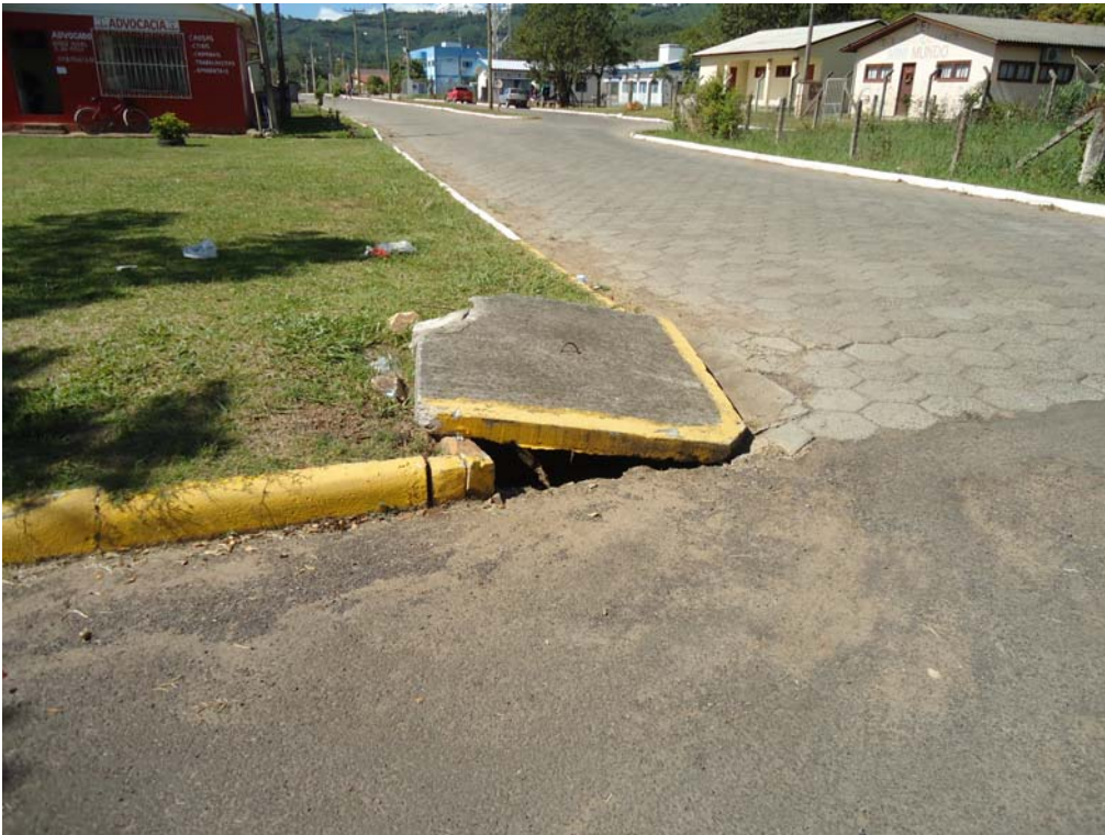
FOTO 12- BOCA DE LOBO DANIFICADA (foto: Roberta Cechin)
